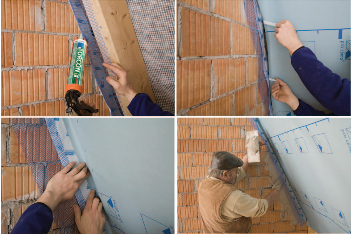
Sealing a foil to plaster using mesh tape (Photos: pro clima Moll bauökologische Produkte GmbH).
