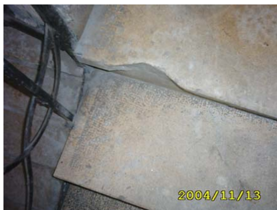
Fig.1.3.4.3-1 Suprafete circulabile uzate, deformate, deteriorate
