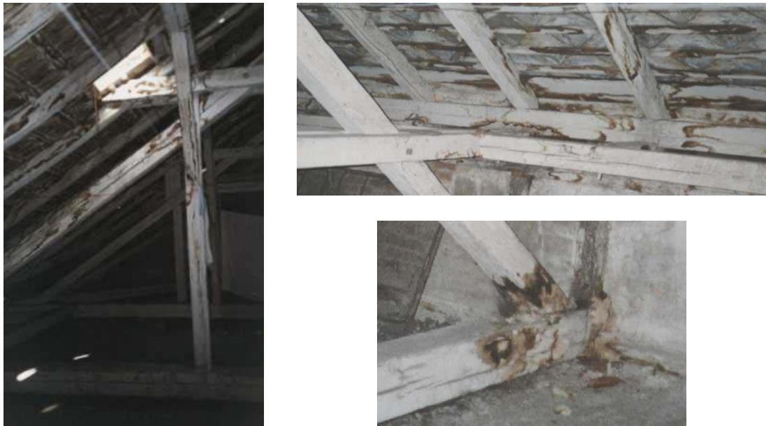
Fig.1.4.3-2 Diferite cazuri de degradare produsa de infiltrarea apei prin invelitoare
