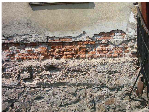
Fig.1.3.1-7 Perete degradat (materiale desprinse, sfaramicioase)
