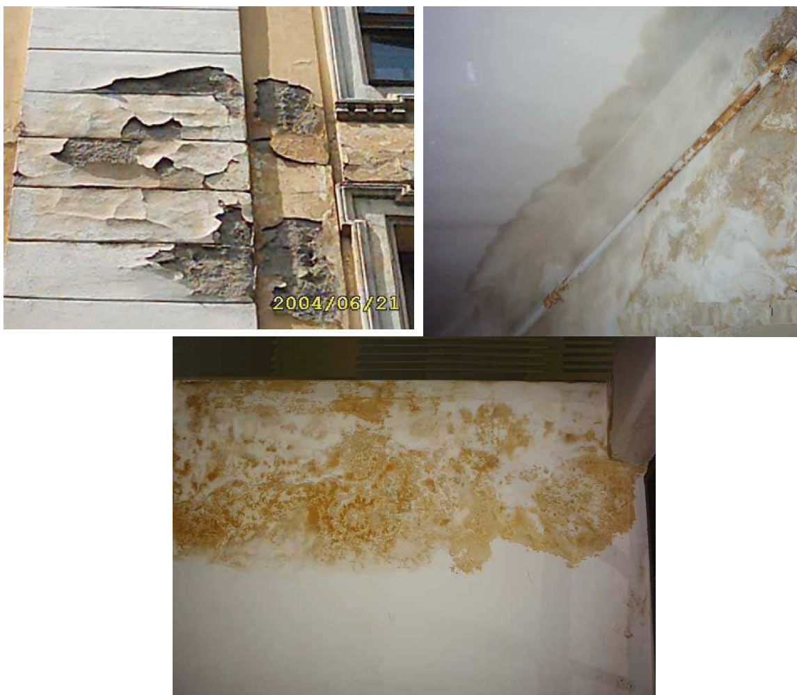
Fig.1.3.1.3 -10 Efecte ale scurgerii din conducte defecte
