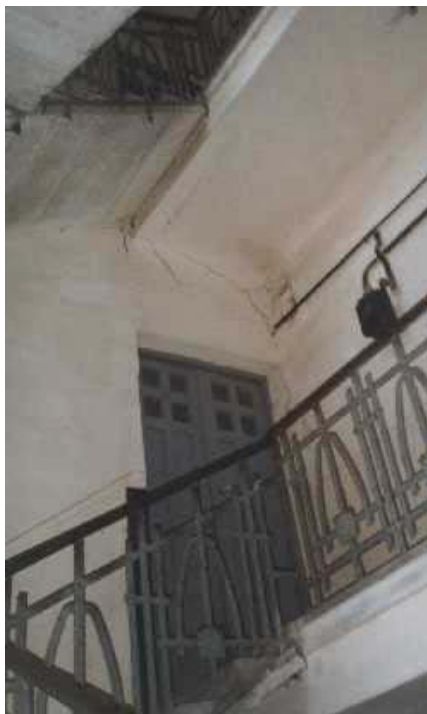
Fig.1.3.4.3-2 Deteriorarea peretelui portant, suport al elementelor scarii
