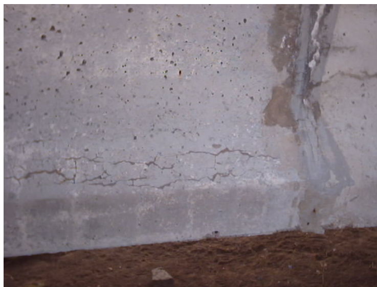
Fig. 6.1 Fisuri în bolțarii prefabricați tipice coroziunii
