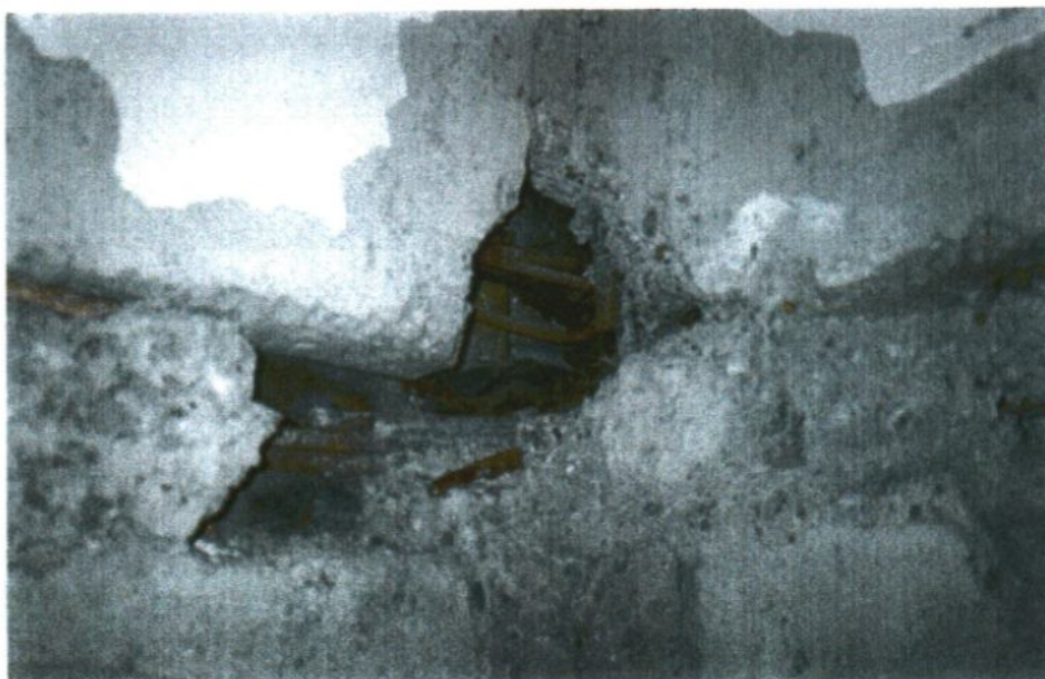
Foto II.4. Armătură corodată în îmbinări la blocuri din panouri mari.
