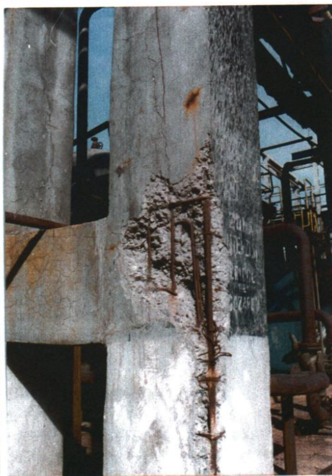
Foto III.10. Betoane segregate și armături corodate în zona segregată și în afara ei
