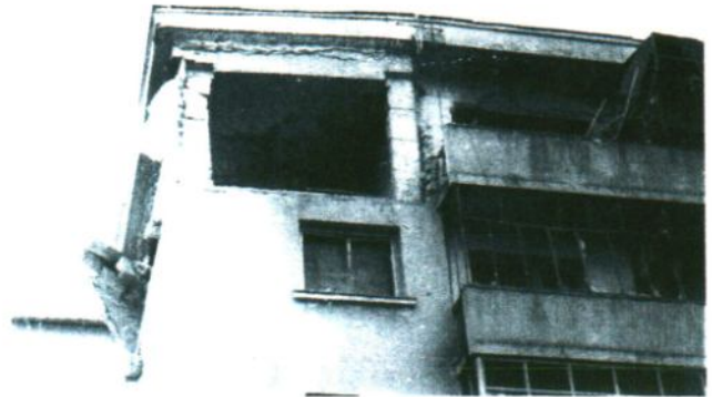
Foto II.46. Avarierea planșeului datorită unei explozii (la același obiectiv).
