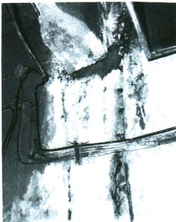
Foto II.41. Îmbinare crăpată datorită tasării terenului sub stâlp
