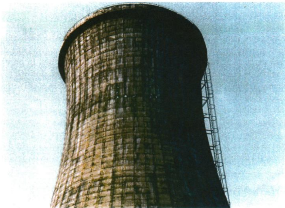
Foto II.26. Degradări ale betonului la un turn de răcire cu tiraj natural
