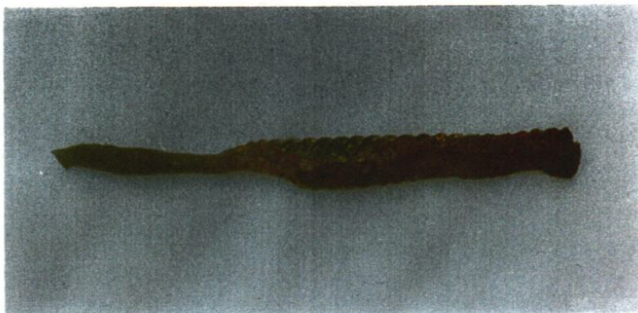
Foto II. 17. Armătură dizolvată prin acțiunea acidului sulfuric (armătură extrasă de la baza stâlpului prezentat în foto II.18)
