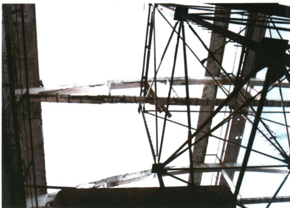
Foto III.2. Arce cu tirant din beton armat puternic degradate
