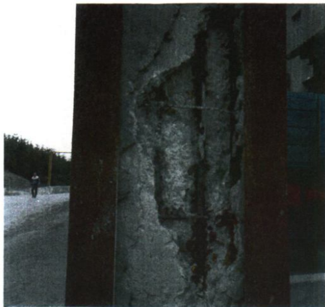
Foto II.7. Degradări violente la stâlpi exploatați în mediu cu umiditate foarte ridicată și ioni de clor
