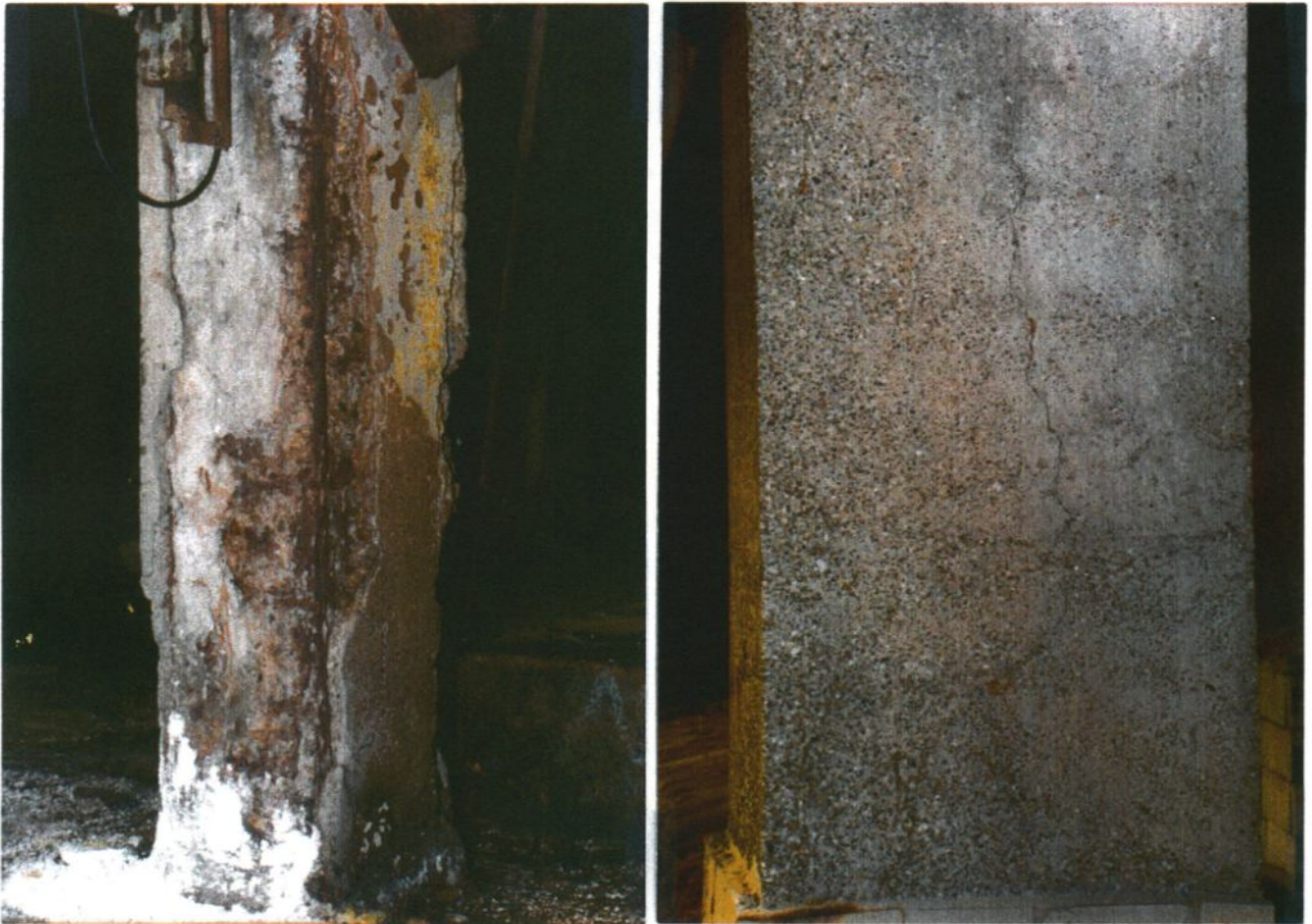
Foto III.6. Cămășuială la un stâlp degradat de acțiunea clorului (stânga), fisurată după cinci ani de la execuție (dreapta)
