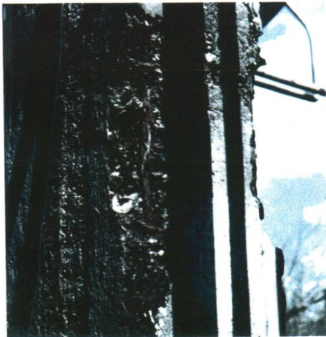
Foto II.31. Degradări ale betonului cu defecte structurale sub acțiunea benzinei.
