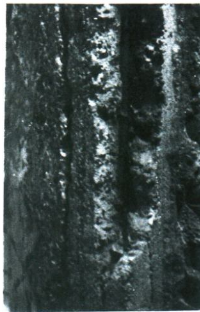
Foto II.8. Degradări violente la stâlpi expuși atmosferei exterioare cu conținut ridicat de sare și variații de umiditate
