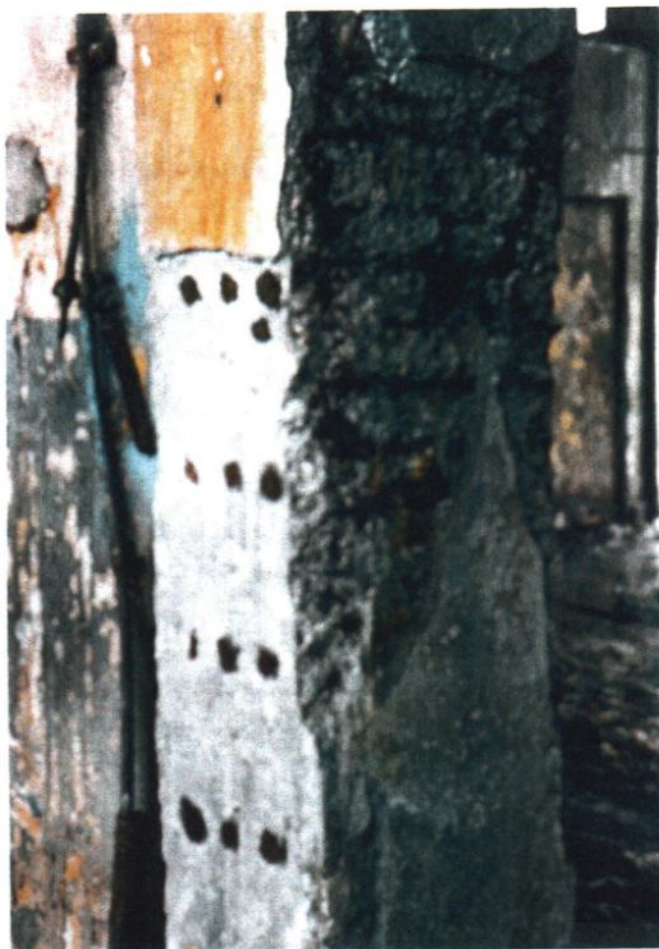
Foto. V.22. Încercări nedistructive ( sclerometrări și sonometrări ) fără relevanță la un stâlp cu armături puternic degradate din acțiunea ionilor de clor
