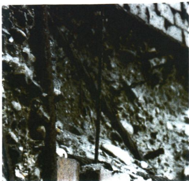
Foto II.20. Dezintegrarea betonului sub acțiunea azotatului de amoniu
