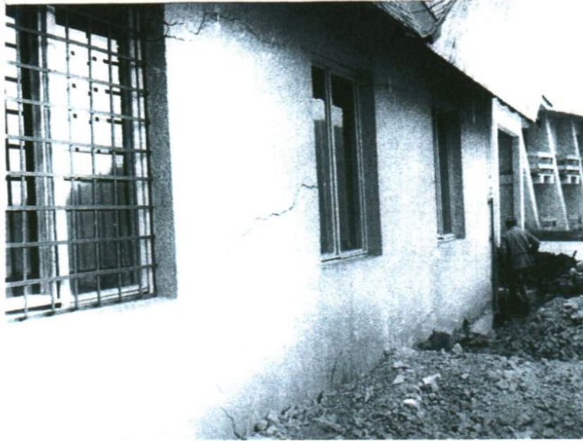
Foto II.43. Avarii la o construcție datorate alunecării terenului
