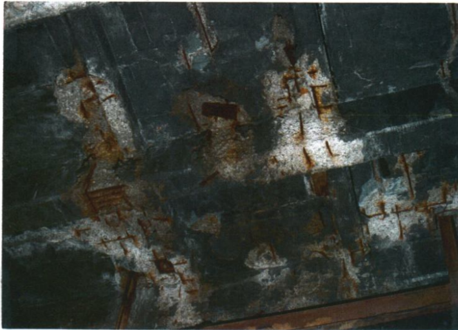
Foto III.12. Planșeu puternic degradat prin infiltrarea de substanțe agresive deversate pe pardoseli
