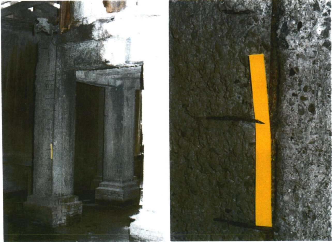
Foto II.14. Degradări la elemente spălate cu soluție de acid sulfuric (ansamblu și detaliu).
