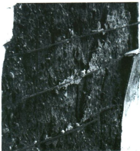
Foto II.21. Cojirea în straturi a betonului și armături secționate datorita acțiunii \text{NH}_4\text{NO}_3
