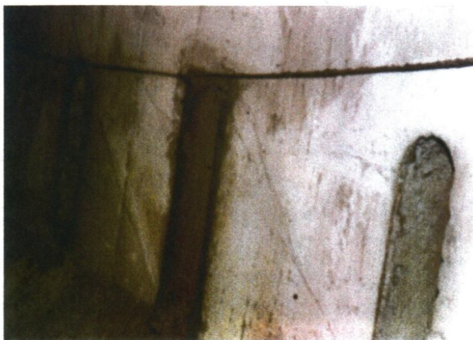
Foto II.42. Fisuri între golurile grinzii canal torsionate datorită deplasării și rotirii stâlpului ( același din foto II.41 )
