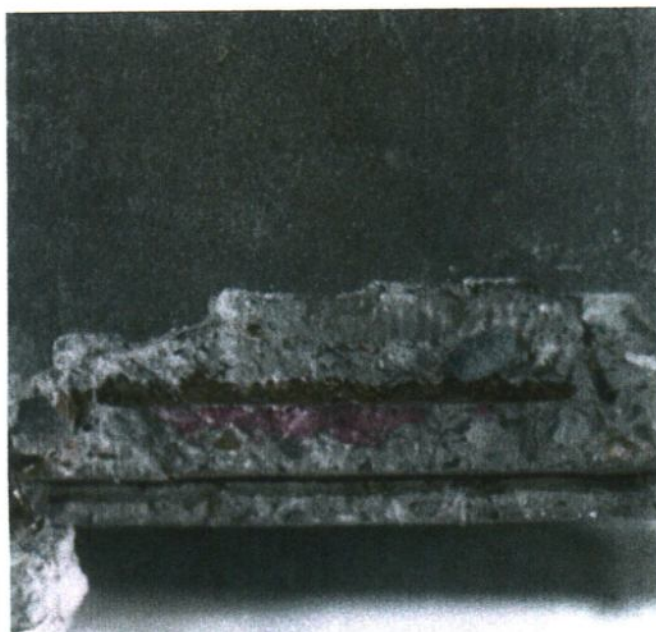
Foto II.2. Armătură cu procesul de coroziune în curs de propagare sub beton de acoperire carbonatat
