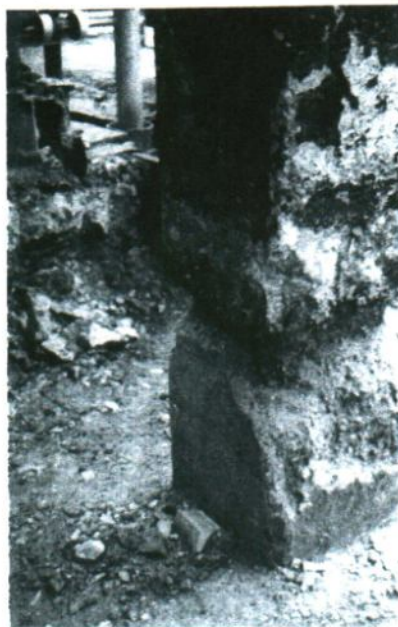
Foto II.19. Stâlp degradat sub pardoseală datorită acțiunii acidului azotic
