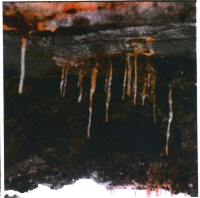
Foto II.16. Dezagregări ale betonului datorate acțiunii sulfatului de amoniu
