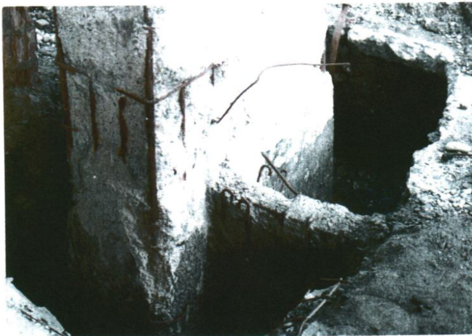
Foto II.40. Fundația stâlpului din foto II.38 sub care terenul de fundare a tasat datorită infiltrațiilor de substanțe agresive.
