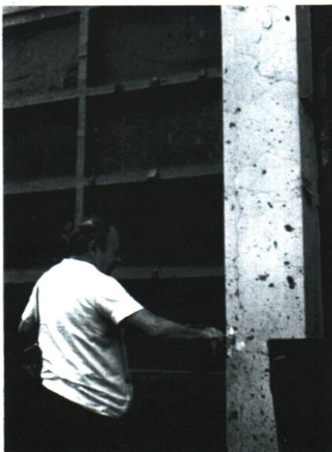
Foto V.1. Examinarea vizuală și prin impact acustic a unui element din beton armat de către profesorul Mihul
