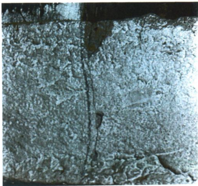
Foto II.3.a. Fisură în îmbinarea dintre două grinzi de rulare
