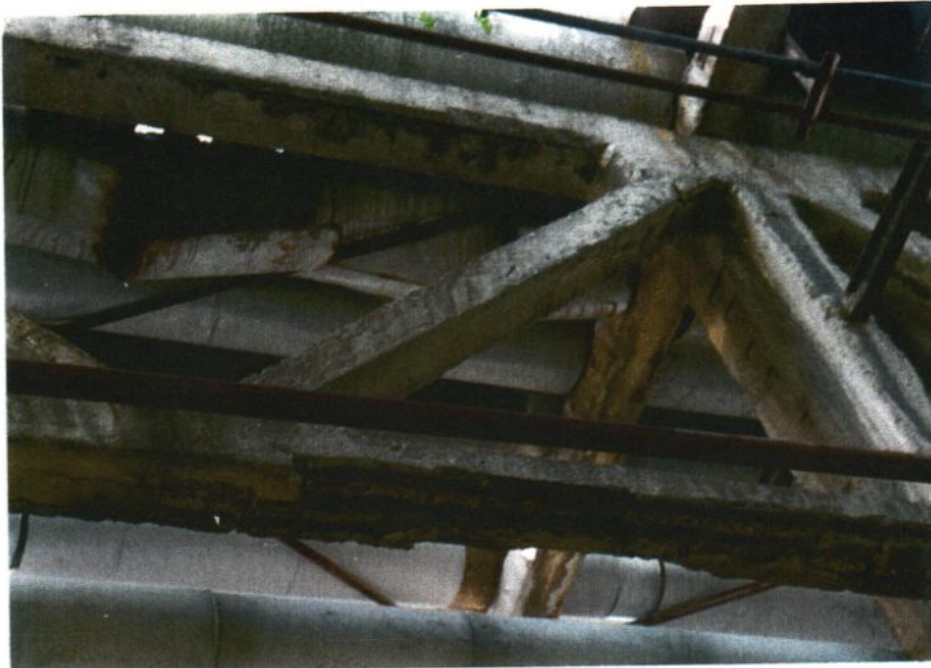
Foto III.4. Grinzi cu zăbrele puternic corodate în mediul industrial
