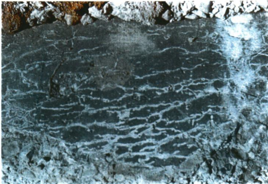
Foto II.34. Degradarea betonului prin expansiunea cimentului
