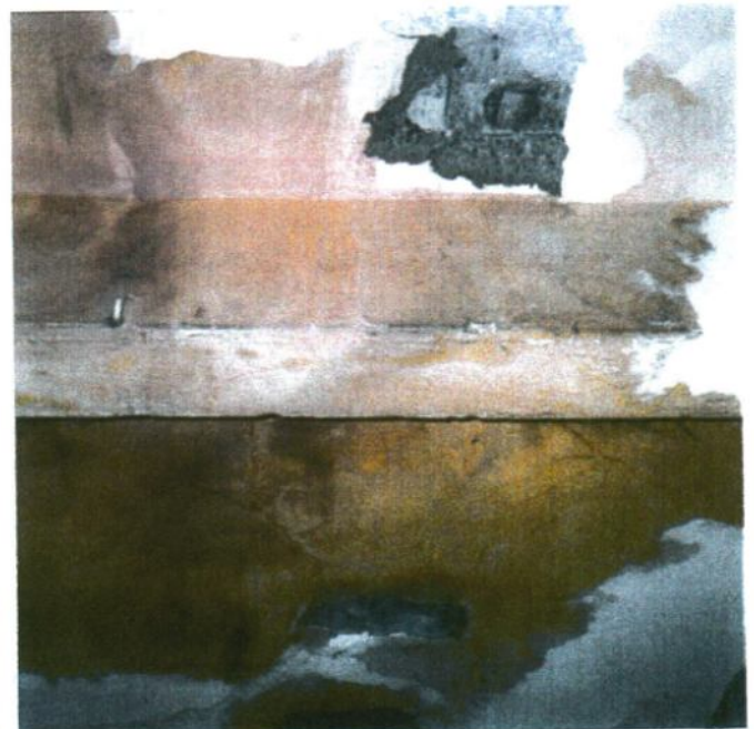
Foto II.32. Degradări la planșee penetrate de uleiuri minerale.
