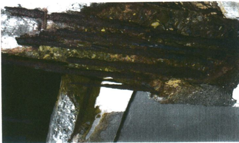
Foto II.11. Coroziunea armăturii sub acțiunea soluțiilor conținând ioni de clor
