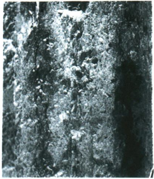
Foto II.6. Exfolieri ale pietrei de ciment la elemente expuse acțiunii \text{Cl}^- și variațiilor de umiditate
