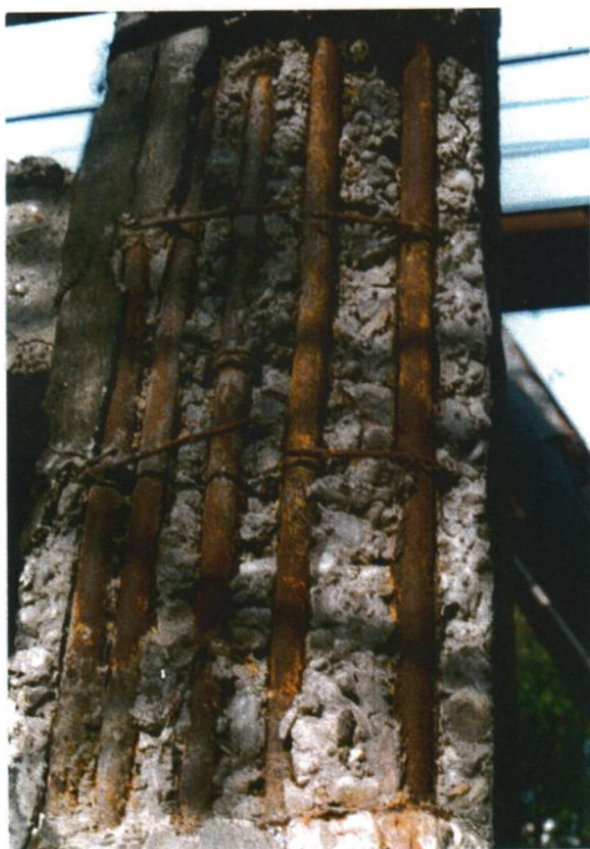
Foto III.9. Armături neînglobate în beton, puternic corodate
