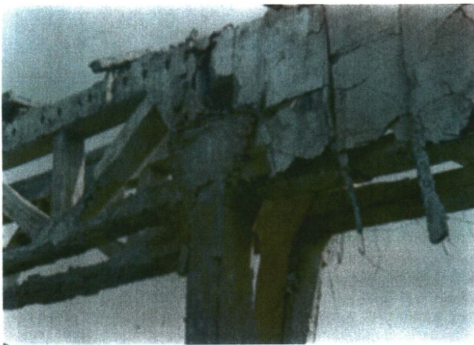
Foto II.44. Degradarea elementelor din beton armat la acțiunea focului
