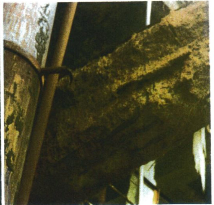
Foto II.30. Degradări datorate hidroxilaminei și mediului exterior -CFS Săvinești
