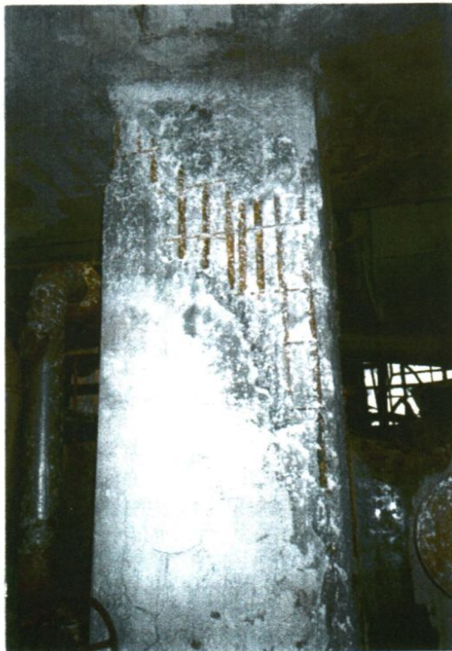
Foto II.37. Crapătura diagonală în stâlp afectat de cutremur și coroziune (vezi și fig. II.30.a 3 )
