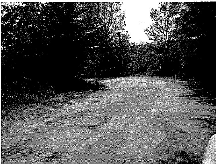
Foto 14. Suprafața de rulare fainanțată puternic, cu gropi și fâgaș longitudinal în structura rutieră pe partea stângă. Reparare necorespunzătoare a gropilor prin plombare
