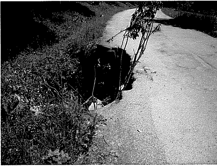
Foto 12. Groapă la marginea părții carosabile, datorată cedării pământului de fundare
