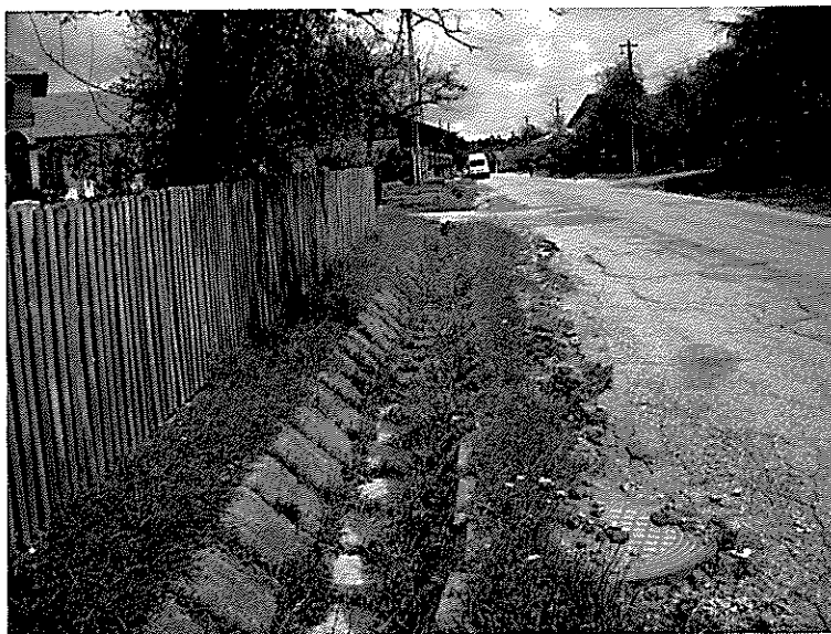
Foto 16. Îmbrăcămintă bituminoasă faianțată, datorită în principal evacuării necorespunzătoare a apelor
