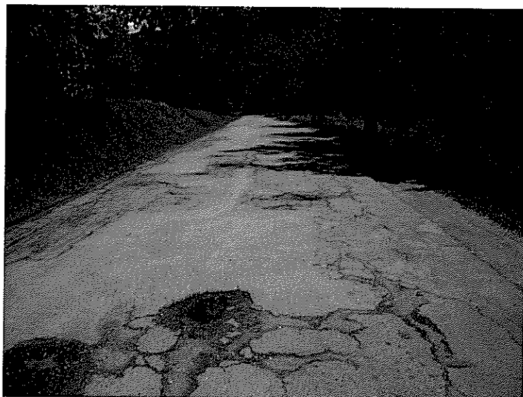
Foto 3. Faianțări și gropi, ca urmare a fenomenului de peladă
