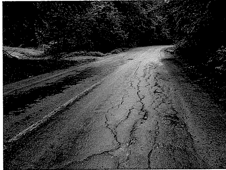
Foto 7. Faianțări sub forma unor rețele de fisuri și crăpături longitudinale, datorate capacității portante neuniforme în profil transversal a complexului rutier
