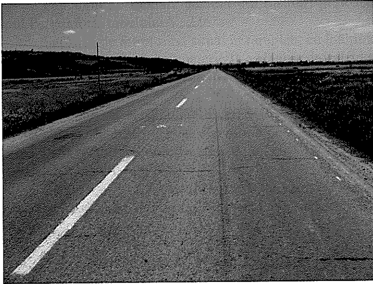
Foto 19. Fisuri transversale, ca urmare a transmiterii la suprafață a fisurilor de contracție din stratul de bază din agregate naturale stabilizate cu ciment
