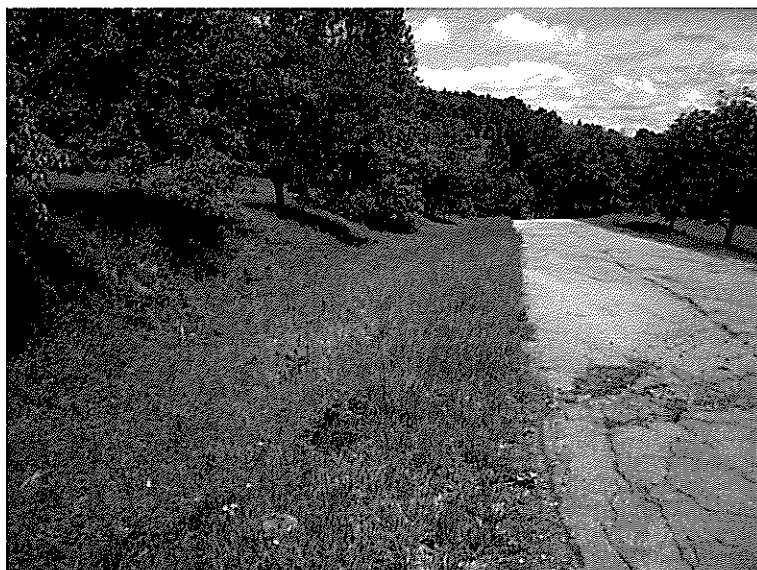
Foto 11. Drum cu faianțări și gropi, datorate scurgerii necorespunzătoare a apelor de suprafață
