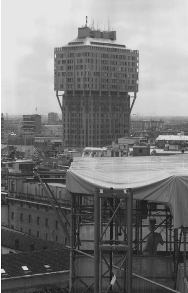
1.3 Torre Velasca, Milan, 1957–1960. Architects: L. B. Belgiojosa, E. Peresutti and E. N. Rogers
