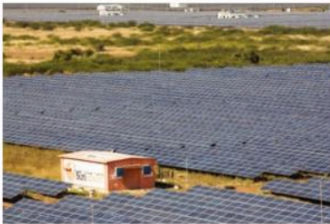
A solar array ▲
