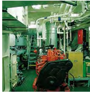
غرفة المحرك ghurfat al-muHarrik engine room
