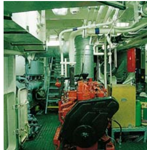
der Maschinenraum engine room
