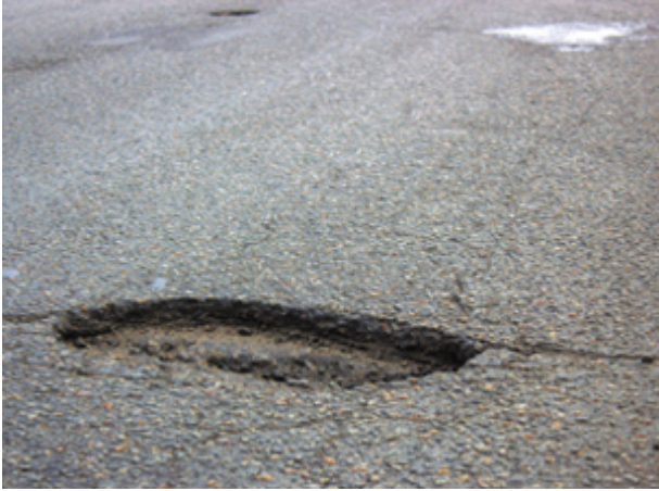
pothole el bache
