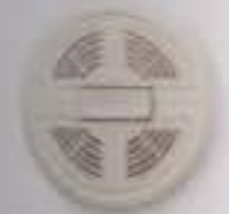
el detector de humo smoke alarm
