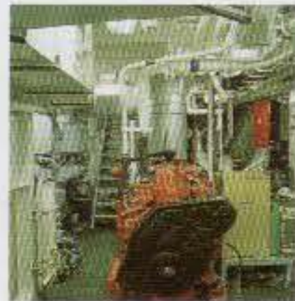
la sala de máquinas / engine room
