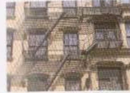
la escalera (la salida) de incendios fire escape
