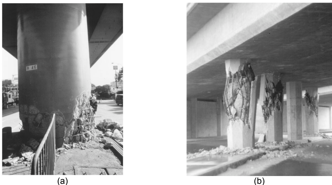
Figura 8.2. Avariarea unei pile de la viaductul Hanshin în timpul cutremurului din 1995 din Kobe, Japonia (a) și cedarea din forță tăietoare la pilele unui viaduct la cutremurul San Fernando, SUA, din 1971 (b), Moehle și Eberhard, 2000.
